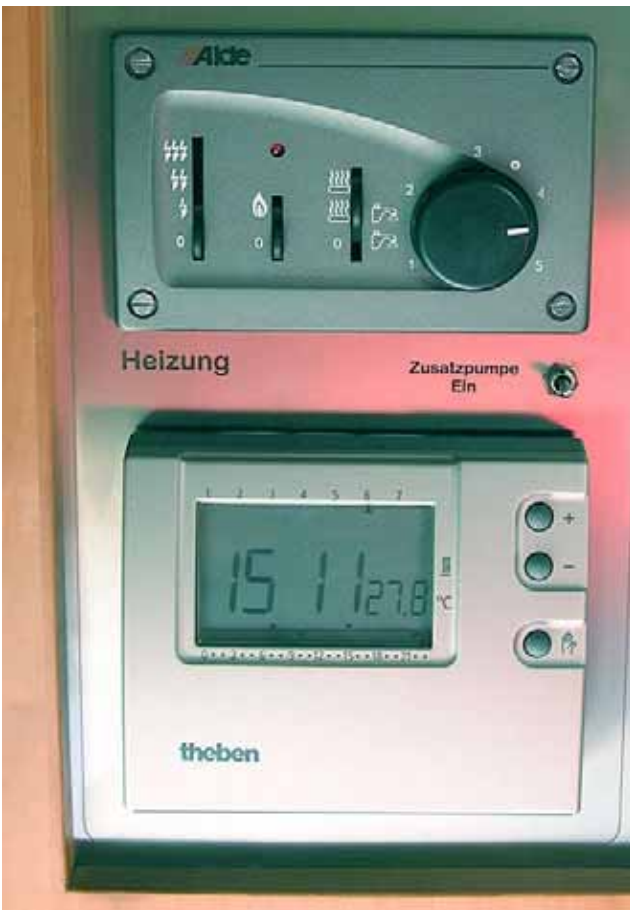
Heizungssteuerung im Controlpanel
