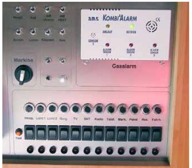
Sicherungen im Controlpanel
