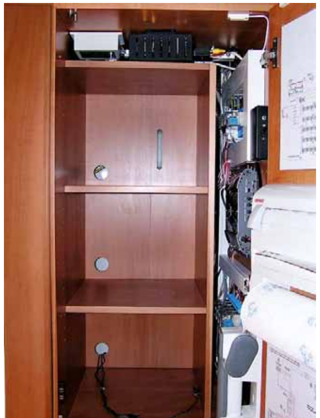
Installation im Technikschränk
