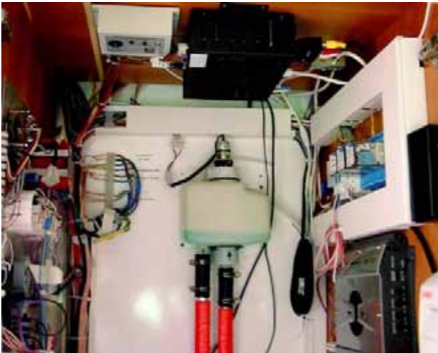
Umfangreiche Installationen im Technikschränk
