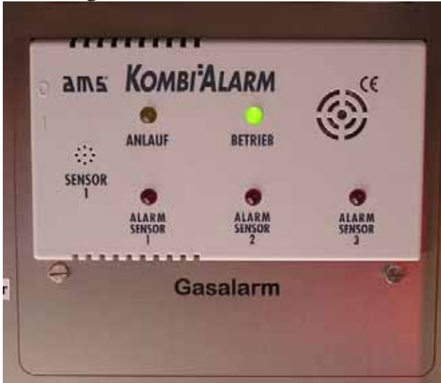
Gaswarngerät im Controlpanel
