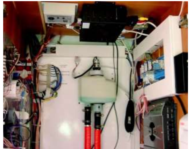
Umfangreiche Installationen im Technikschränk
