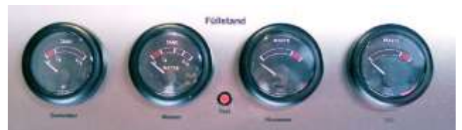
Tankanzeigen im Controlpanel
