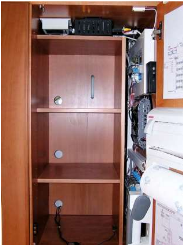
Installation im Technicschrank
