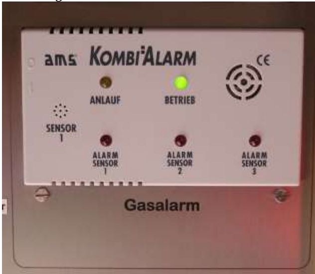
Gaswarngerät im Controlpanel
