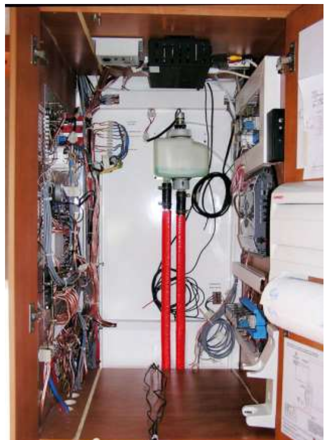
Verwirrende Installation, nur auf dem 1.Blick
