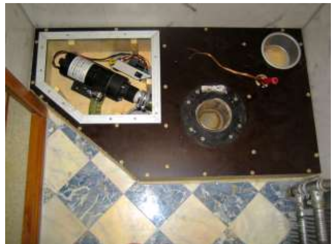
Konsole mit untergebrachtem Häcksler und Anschlüssen
