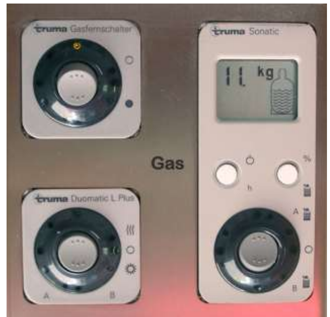
Steuerung der Gasanlage im Controlpanel
